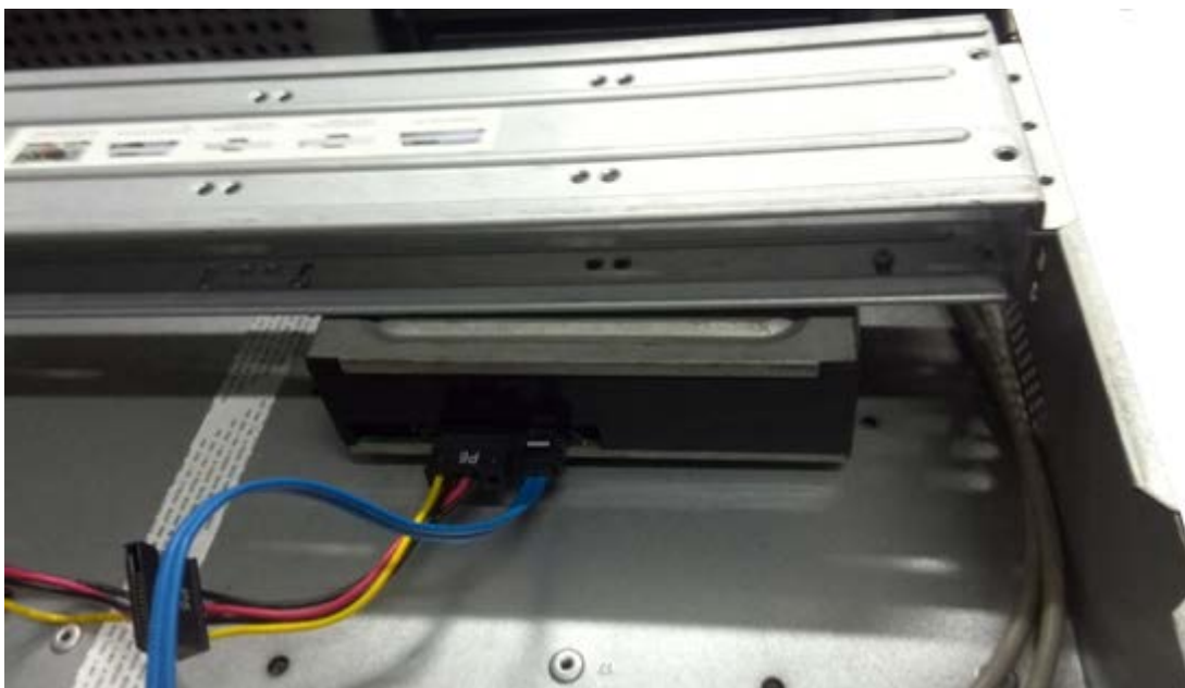
Figura 3-41 Cables de conexión
